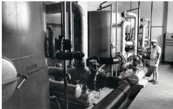
» die neue Filteranlage nach der Sanierung
