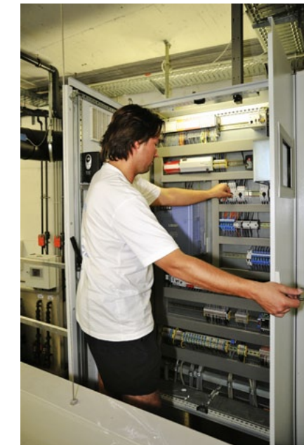
» Schaltschrank für die Technik im Bad
