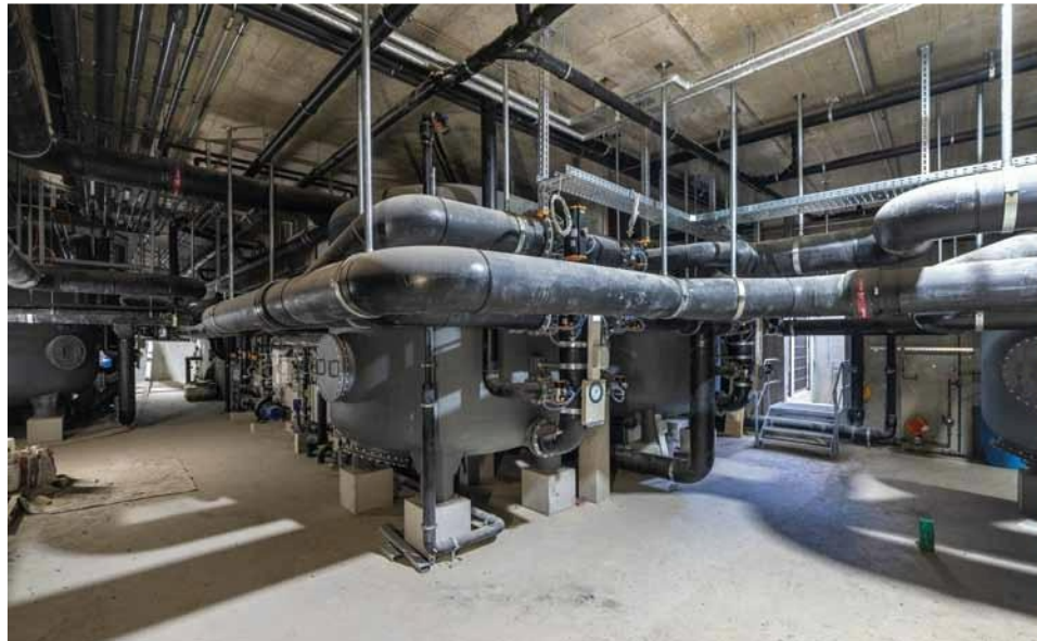
Ein Blick in den Technikkeller.
